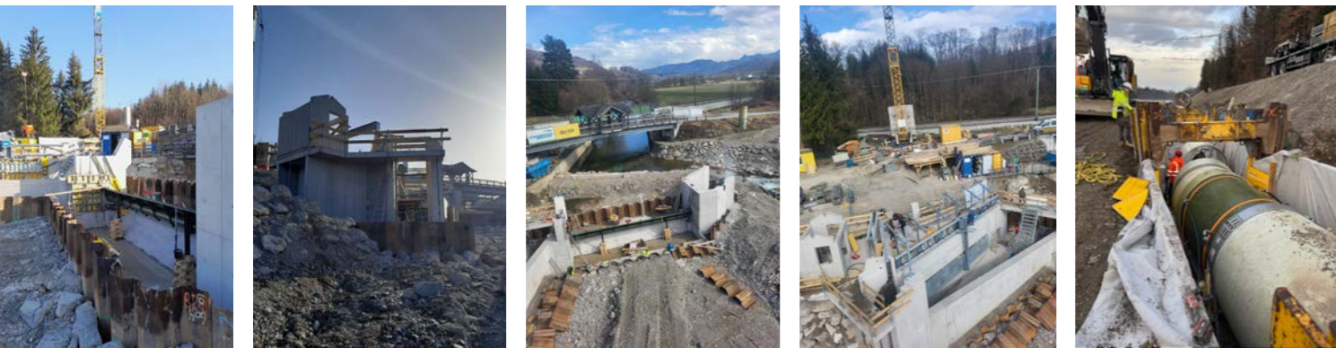
Wasserkraftwerk Muntigl | Bergheim
