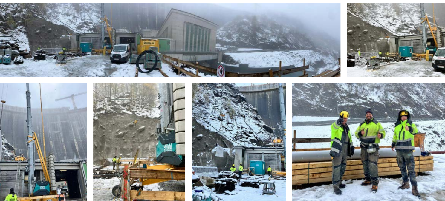
Trafo Limberg | Kaprun
