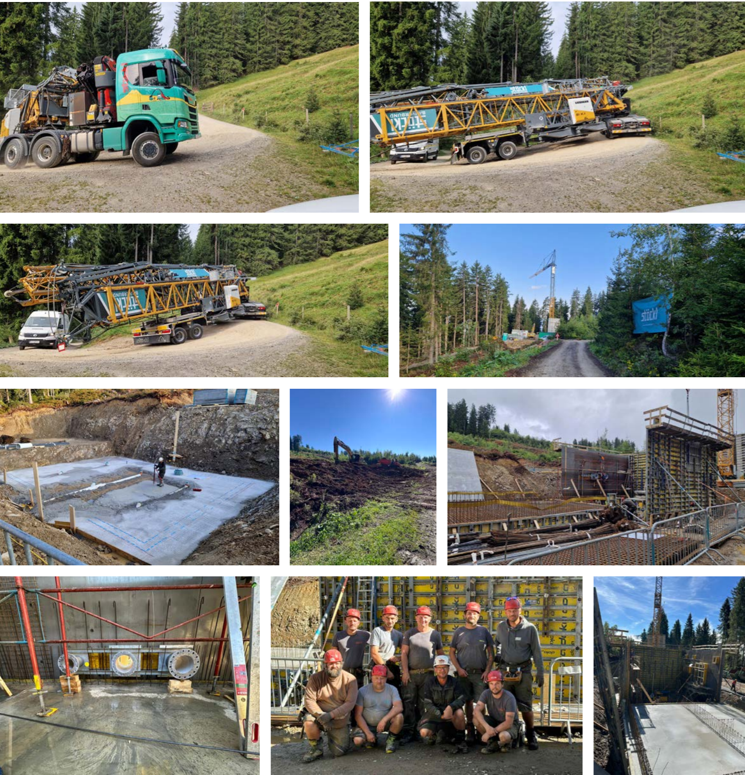
Pumpstation Hohe Salve II | Hopfgarten
